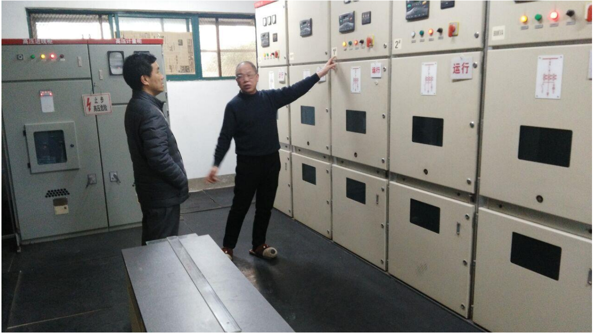
高压配电室安全检查
