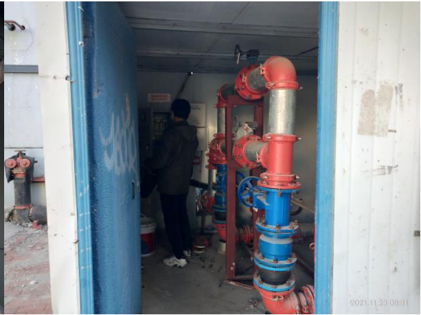
消防设备检查
