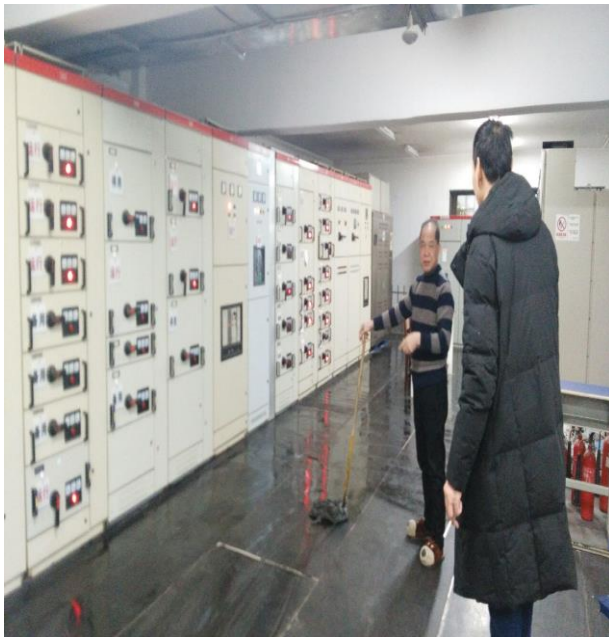
电力设备检查
